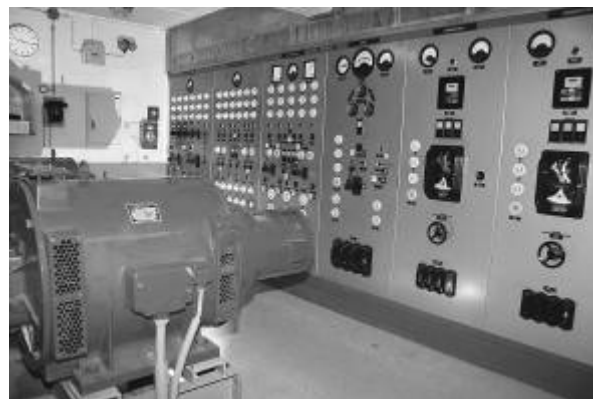
Stromschalt- und Verteiltableau Armadio di comando e distribuzione
