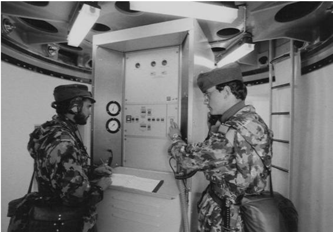
12 cm Fest Mw 86: Geschützführer und Richter am Steuerschrank im Richtraum Lm fort 12 cm 86: capopezzo e puntatore all'armadio di comando nel vano di puntamento
