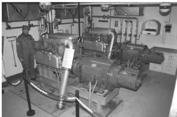
Maschinenraum mit zwei 80 PS Sulzer-Dieselmotoren Sala macchine con due motori diesel Sulzer da 80 CV
